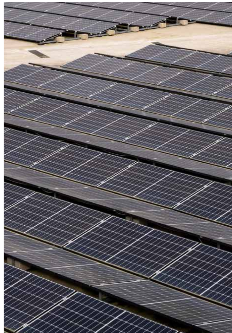
Fotovoltaïsche panelen op de Wevelgem (B) site
