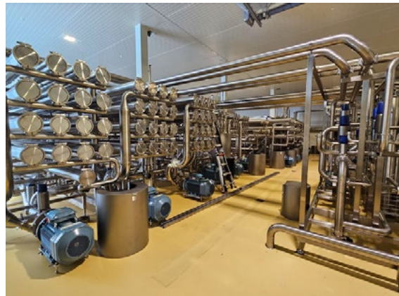
De nieuwe UF/RO installatie in Langemark werd in 2023 in gebruik genomen
