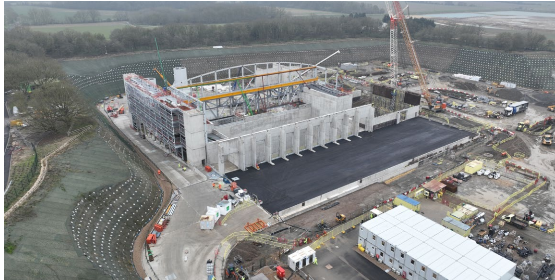
Onze allergrootste verwerkingsinstallatie kreeg snel vorm in 2023.
