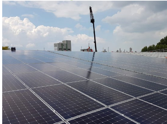
670 zonnepanelen bij IWS Terneuzen (NL).
