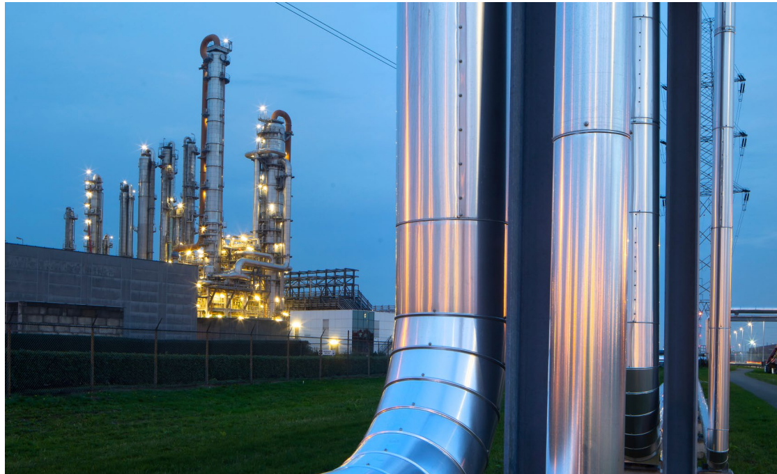
Stoomnetwerk ECLUSE levert groene energie uit Waste-to-Energy installaties in Doel (BE) aan de industrie.
