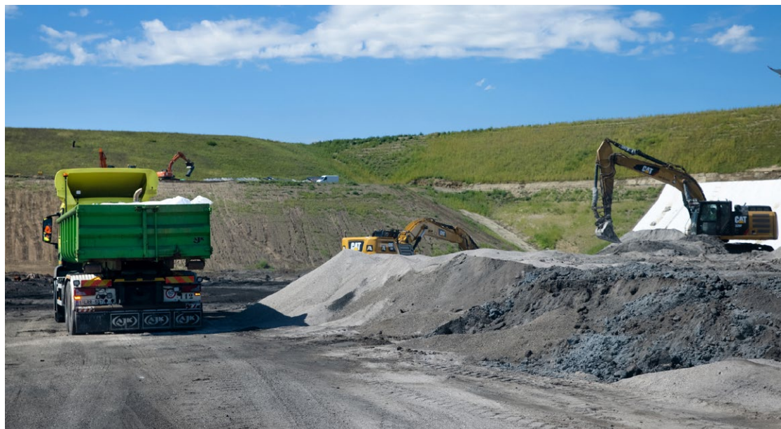
Gevaarlijk afval wordt veilig geborgen op onze stortplaatsen.
